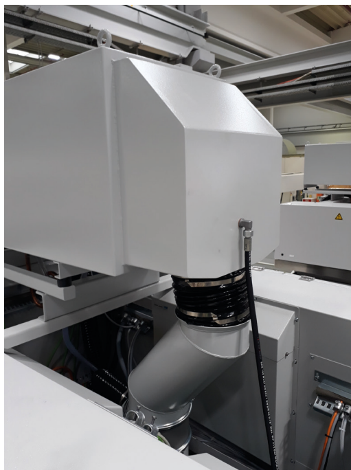
Photo 04: Raccordement du tuyau de passage de l'agent d'extinction
